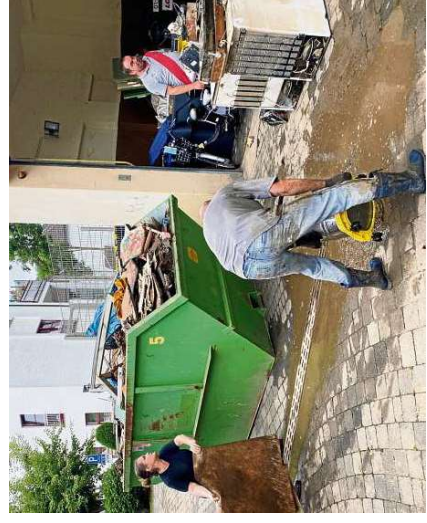
In der Fleischerei Webers ist ein riesengroßer Schaden entstanden. Viele Helfer räumten auch am Wochenende im Hof auf.
